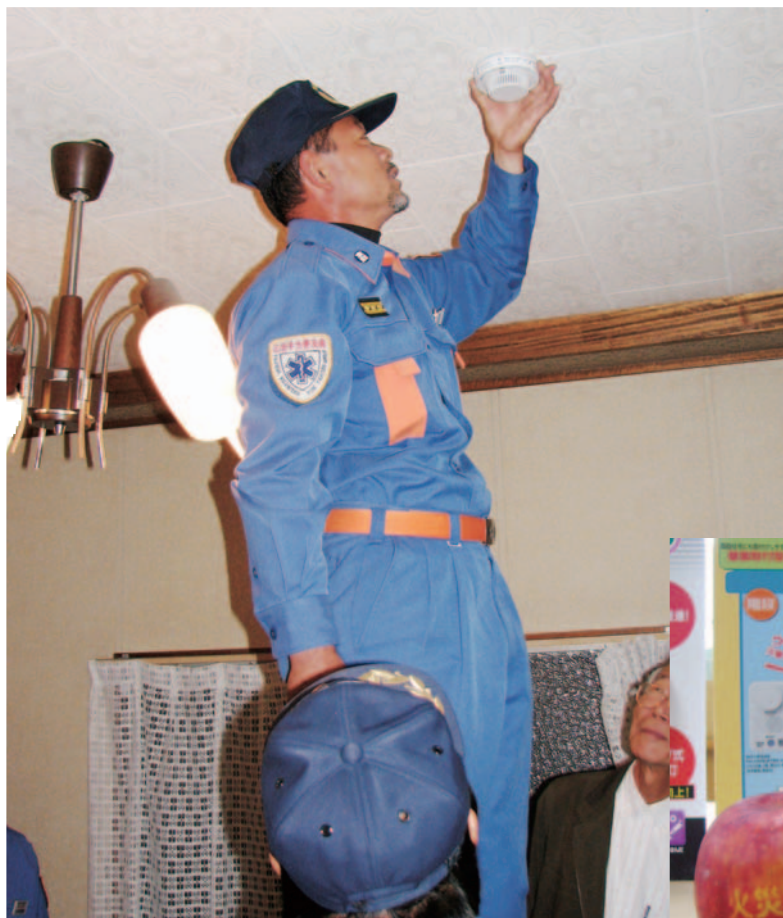
住宅用火災警報器設置の様子
